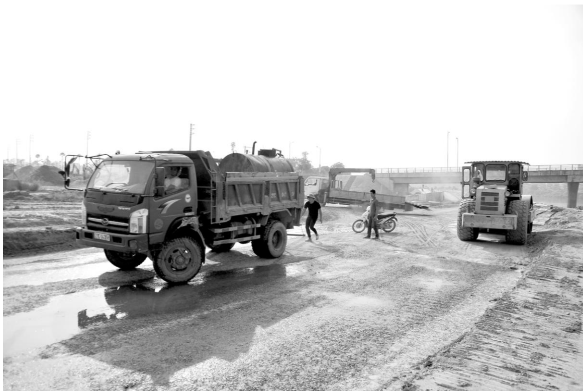
Công nhân Liên danh Lâm Việt - Bình Dương đẩy nhanh tiến độ thi công dự án xây dựng công trình đê chống ngập sông Hồng.
