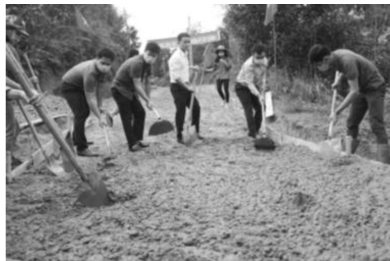
Khởi công công trình "Con đường em đến trường" tại thôn Phú Thôn, xã Yên Phú.
